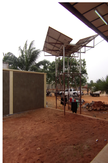
Les panneaux solaires actuels. Photo Mélanie Martel, 2019
