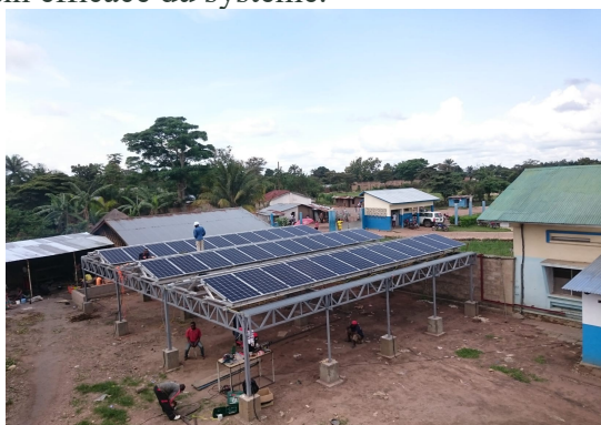
72 panneaux photovoltaïques. Photo Roland Hensens
